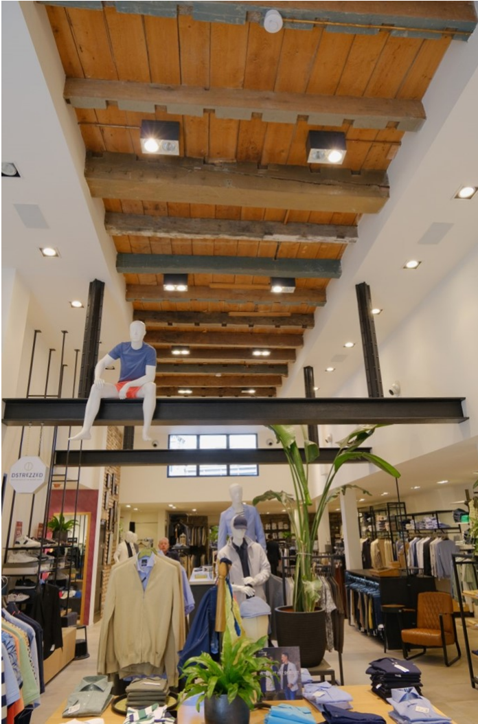
De ingekorte gekoppelde ijzeren kolommen die de verdiepingsvloer ondersteunen, met daaronder de in 1967 aangebrachte onderslag balk.
