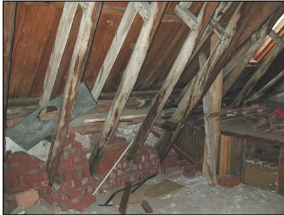
Overzicht van de zolderborstwering ter hoogte van getekende doorsnede A. De daksporen en A-spant nummer 3 steunen op een ingemetselde muurplaat die op de foto schuilgaat achter de los gestapelde bakstenen.
