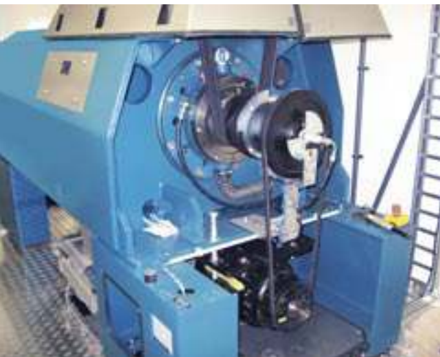
De in 2008 geïnstalleerde decanter voor de ontwatering van nat slib
