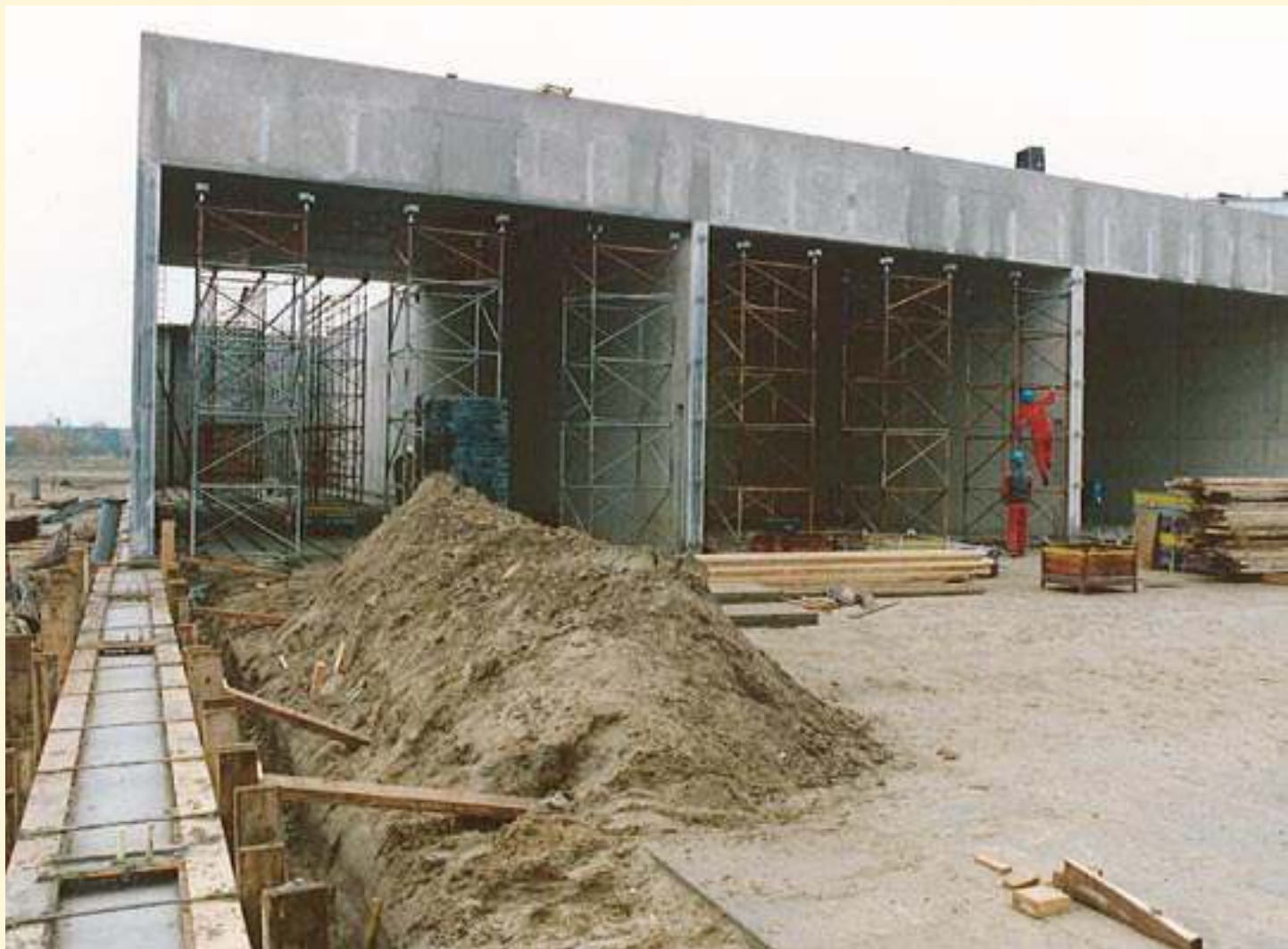
In 1993 bouwde Midden-Betuwe Slibverwerking een tweede composteringsinstallatie in Zutphen, geheel overdekt en ingericht voor tunnelcompostering.
